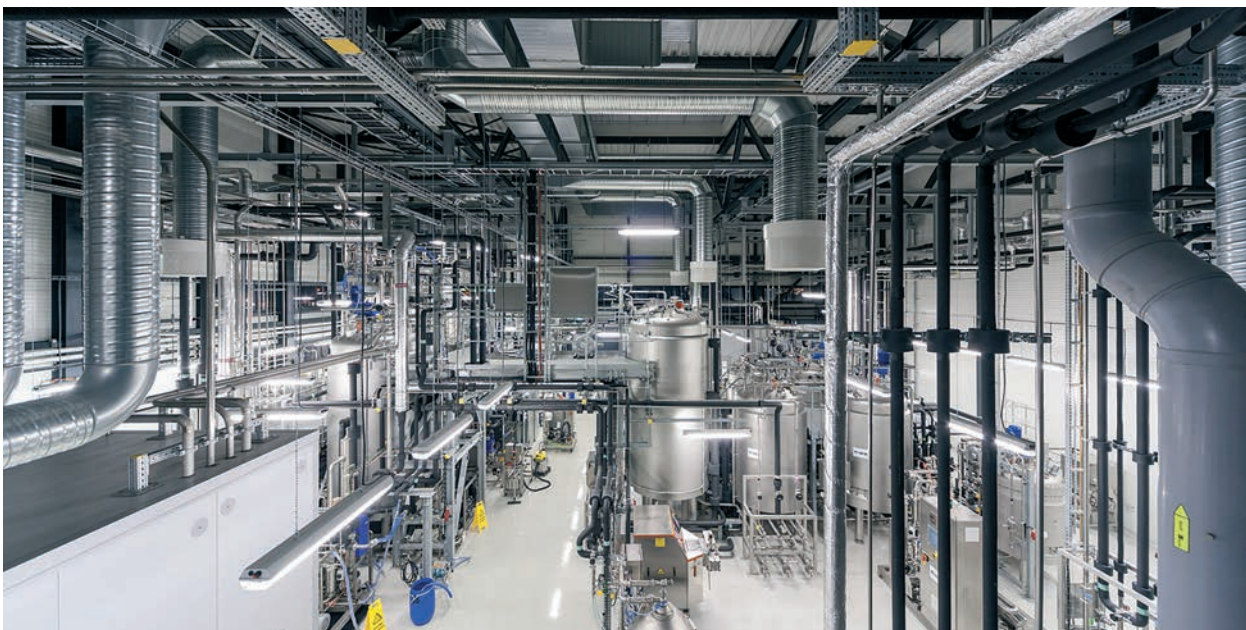
Am ehemaligen Chemiestandort Leuna ist mit dem Fraunhofer-Zentrum für Chemisch-Biotechnologische Prozesse (CBP) eine Bioraffinerie entstanden, in der der Rohstoff Holz auf verschiedene Weisen zu biobasierten Wertstoffen verarbeitet werden kann.
